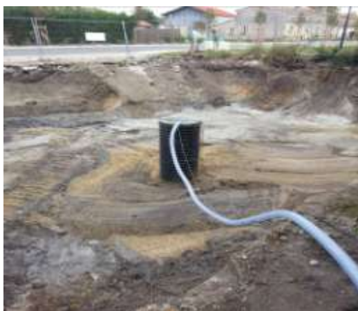
Puits de drainage
