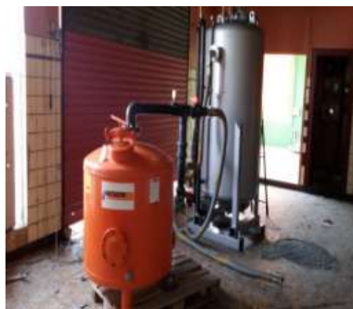
Complexe filtre à sable-Filtre à charbon actif
